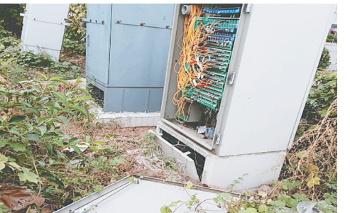
桂江路与梅花山路交叉口向西约15米路北，通信交接箱门损坏。
