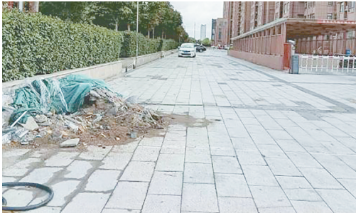
湘江东路与燕山南路交叉口向东约50米路南，渣土未及时清理。
