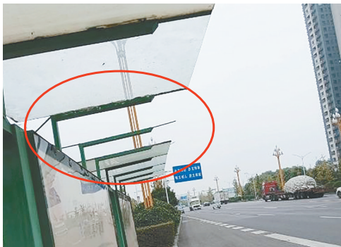
中山南路与湘江东路交叉口向南约60米路东，公交站亭顶棚玻璃缺失。
