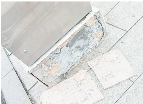
受降路与交通南路交叉口向东约2米路南，交通信号灯箱体底座瓷砖脱落。
