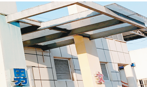
龙江东路与许慎路交叉口向西约270米路北，公共厕所顶棚玻璃破损。
