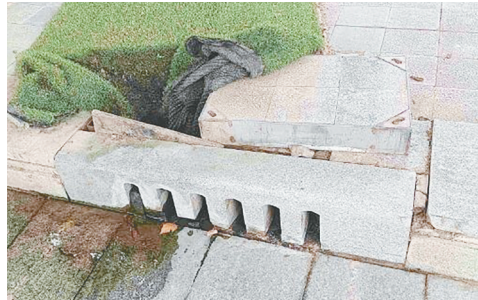
太白山路与月湾湖东路交叉口向北约10米路东,雨水井盖移位。
