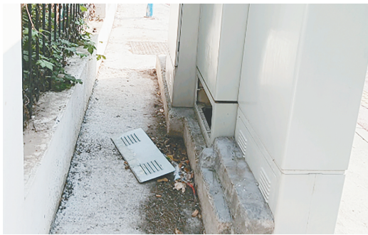
汉江路与井冈山南路交叉口向西约5米路北，通信交接箱门脱落。
