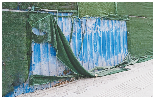
漯河路与东北路交叉口向西路南，天润府小区施工围挡上的装饰布破损脱落。
