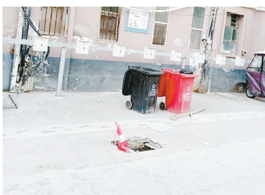
银鸽二巷与银鸽大道交叉口向西约60米路北，银鸽西院6号楼2单元门前雨水篦子破损。
