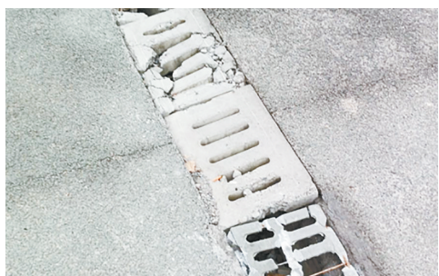
洋河路与云翠山路交叉口向东约70米路南，人行道上雨水篦子破损。
