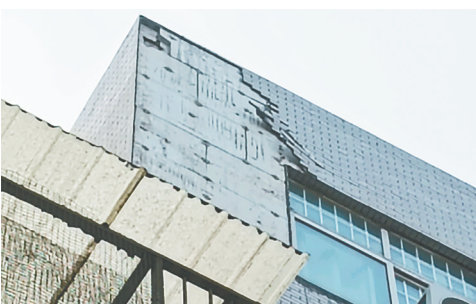
市场东路与泰山路交叉口向西约40米路南，临街楼外立面瓷砖脱落。
