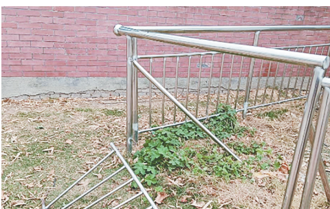
宝塔山路与嘉陵江路交叉口向北约10米路东，通信基站围栏损坏。
