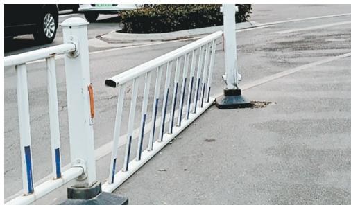
人民路与五一路交叉口向东约10米路北，交通护栏脱落。
