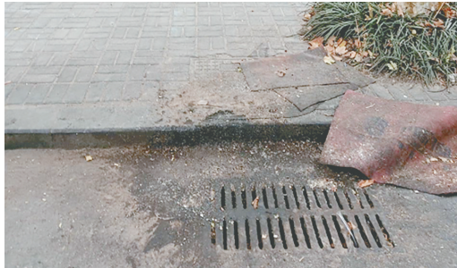
柳江路路与峨眉山路交叉口向东约100米路北，主路面雨水篦子上有油污。
