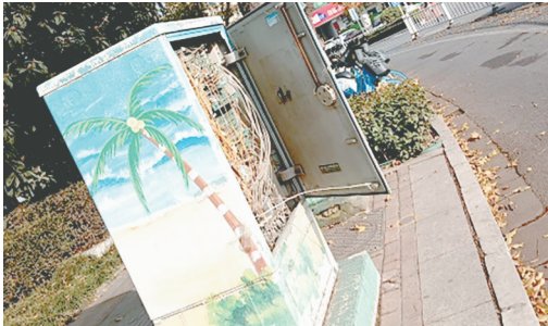
长江路与嵩山南路交叉口向西约15米路北，通信交接箱箱门未关闭。
