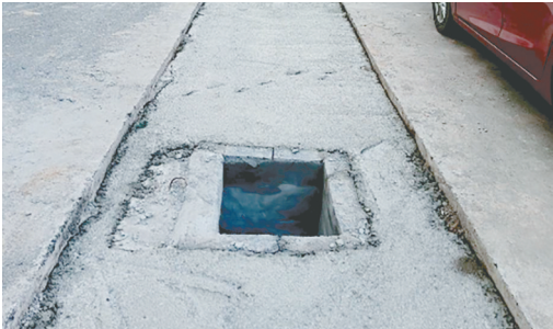
泰丰西巷与人民东路交叉口向北约20米至80米之间路东，污水井盖缺失。
