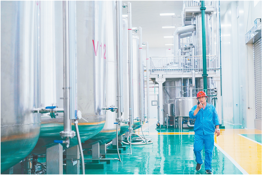
河南益恒源生物科技有限公司塔格糖生产线开车试产。
