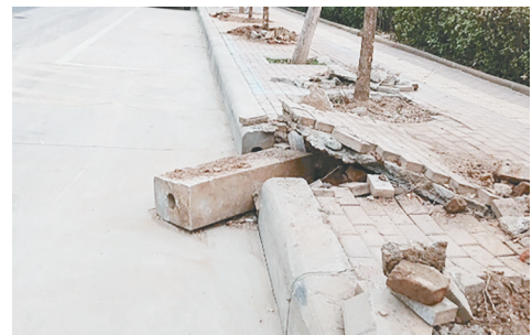
潢江路与桐柏山路交叉口向西约120米路南,人行道路面破损,道边石损坏。
