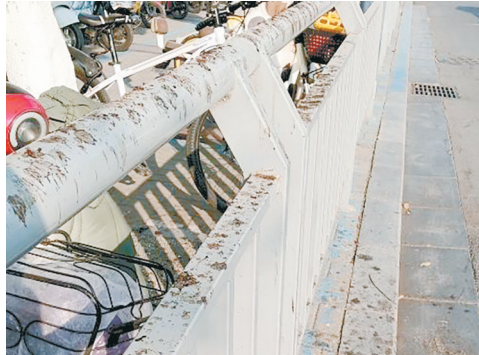
交通南路与湘江西路交叉口向北约100米路西，人行道隔离栏脏污。
