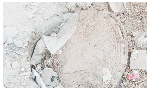
梅花山路与汇丰街交叉口向南约60米路东,井盖沉陷。
