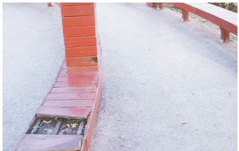
黄河西路与祁山路交叉口向西,黄河广场内街头座椅木板缺失。
