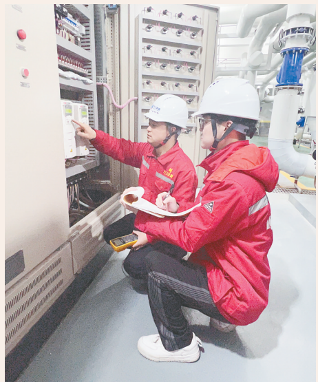
漯河中裕燃气有限公司检修人员对设备进行安全检查。 本报记者 于文博 摄
