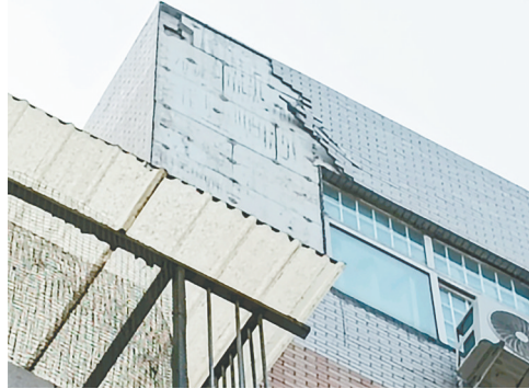
市场东路与泰山北路交叉口向西约40米路南,临街楼外立面瓷砖脱落,存在安全隐患。
