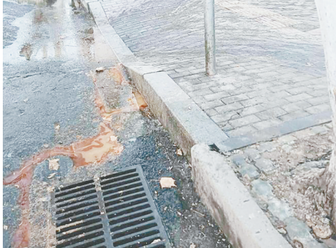
解放南路与滨河东路交叉口向南约20米路西,排水管道堵塞,污水横流。
