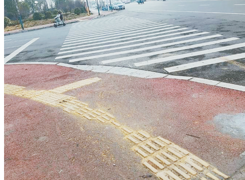
滦河路与宏图路交叉口向西约1米路北,盲道破损。
