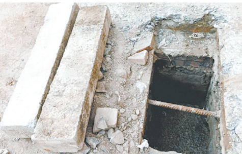
梅花山路与汇丰街交叉口向南约70米路东，污水井盖缺失。
