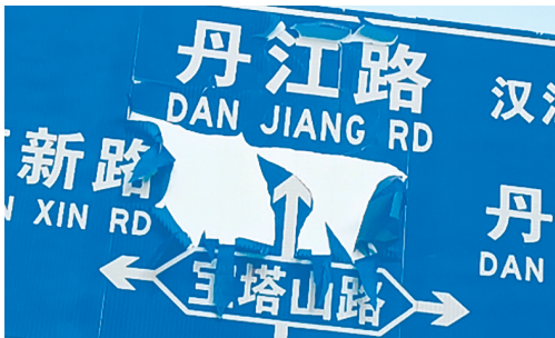
涇河路与宝塔山路交叉口向西约30米路南，交通标牌破损。
