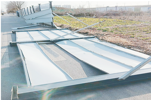
翠华山路与嘉陵江路交叉口向北约10米路西，围挡倒地。
