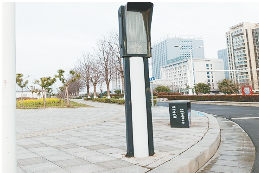
汉江路与九龙山路交叉口向西约2米路南，人行道交通信号灯不亮。
