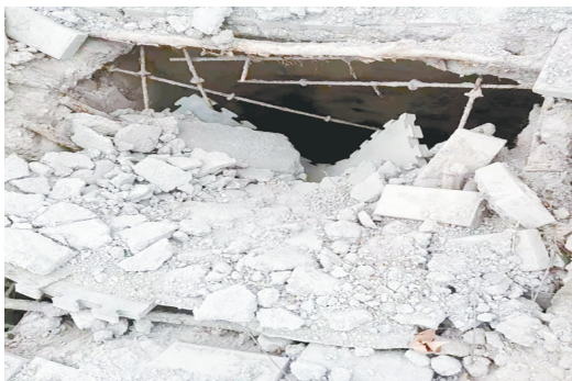
淞江路与白云山路交叉口向西约350米路北，污水井盖碎裂。
