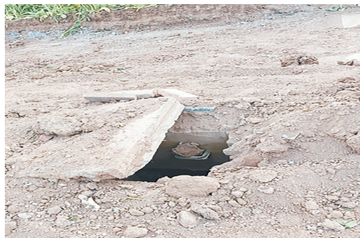
玉泉山路与牡丹江路交叉口向北约150米路东，污水井盖移位。
