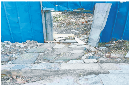
洋河路与燕山路交叉口向东约120米路北，围挡破损。
