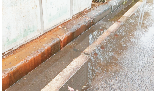
黄河中路与崂山路交叉口向西约20米路北,雾森系统漏水。
