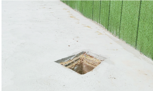
庐山路与黄河东路交叉口向南约30米路东,人行道上窨井盖缺失。
