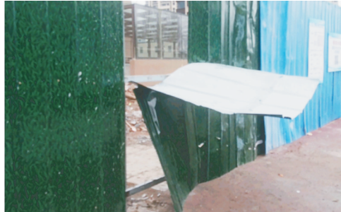
宝塔山路与汪河路交叉口向南约90米路西,绿地城施工围挡破损。
