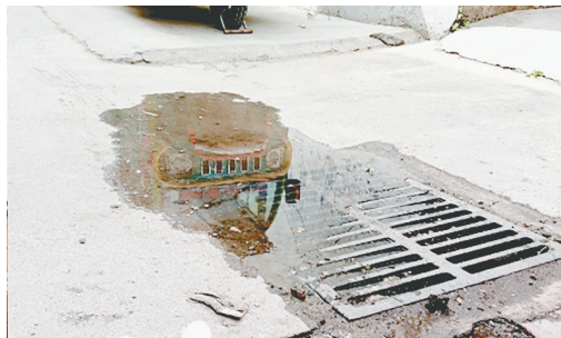
礼貌巷与短工市街交叉口向北约20米,排水管道堵塞,污水横流。
