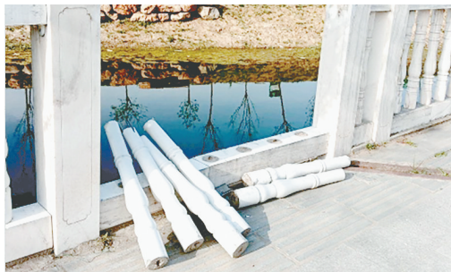
柳江路路与锦屏山路交叉口向东约100米路北,桥上护栏损坏。
