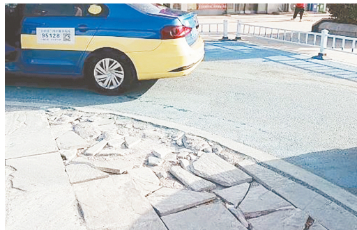
翠华山路与长江路交叉口向北约100米路西,地磚破损。
