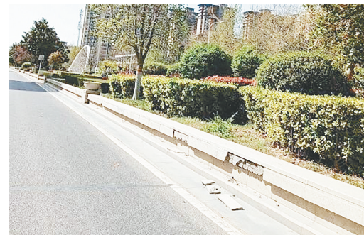
太白山中路与芙蓉江东路交叉口向南约10米,瓷磚脱落。
