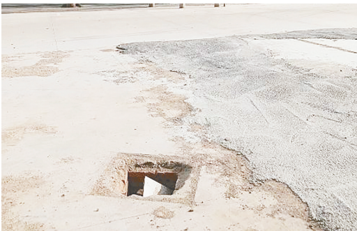
淞江路与新川路交叉口向东约100米路南,井盖缺失。
