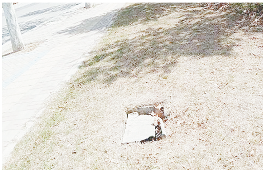
龙江西路与千山路交叉口向东约100米路南,井盖破损。
