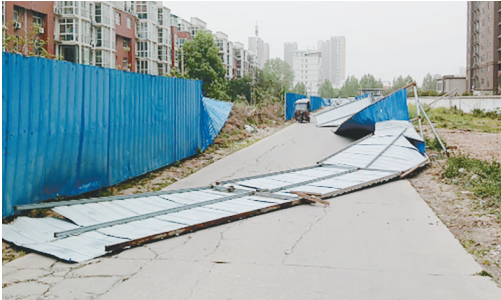
幸福渠路(井冈山北路至许洼东街)两侧,围挡破损倒地,影响通行。
