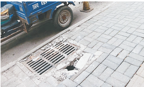
青河路与太行山北路交叉口向西约30米路南,人行道上井盖周边破损。
