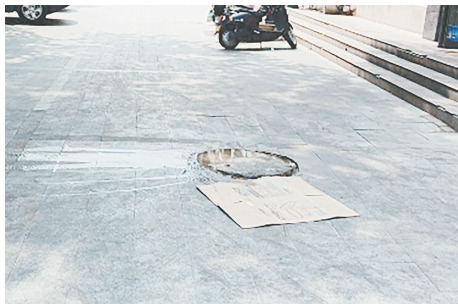
解放南路与湘江东路交叉口向南约60米路西,排水管道堵塞。
