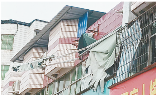
友爱街与民主路交叉口向北约80米路东,临街楼遮阳篷破损,存在安全隐患。
