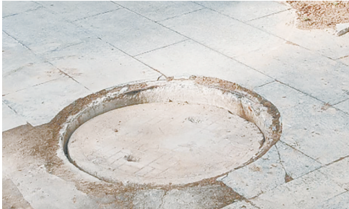
解放路与湘江路交叉口南侧路西，临街门面房前多个井盖沉陷，存在安全隐患。
