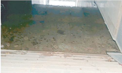
翠华山路与汉江路交叉向北约10米路西，地下通道顶棚破损、内有污水。
