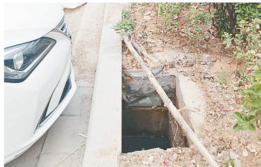
玉泉山路与玉河路交叉口向南约100米路西,井盖缺失。
