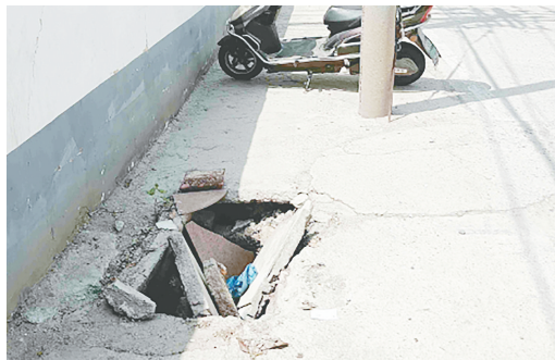
阮庄路与岷山路交叉口向西约60米路南,井盖破损。
