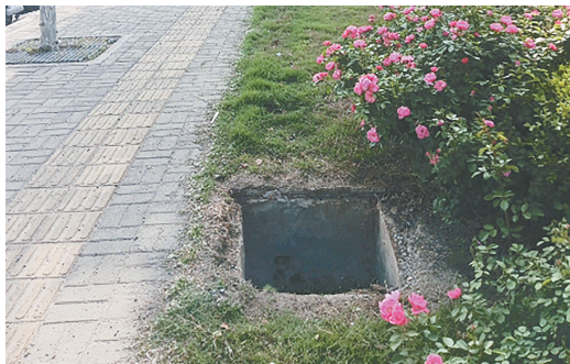
龙江西路与金山北路交叉口向西约10米路南,井盖缺失。
