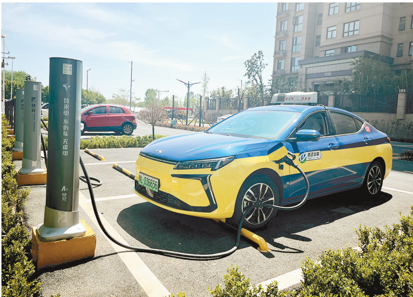
新能源汽车在漯河市政集团黄河路玉山路公共充电站充电。
