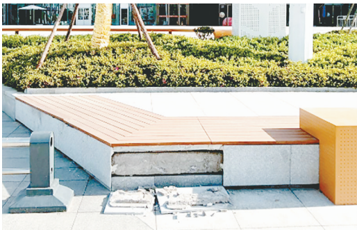
长江路与太白山中路交叉口向东约30米路北，瓷砖脱落。
