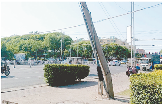
太行山北路与淞江路交叉口向北约30米路西，线杆断裂，存在安全隐患。
