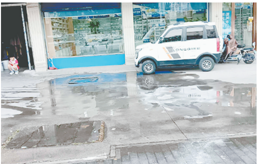
衡山路与人民东路交叉口向南约90米路西，下水道堵塞，污水外溢。
