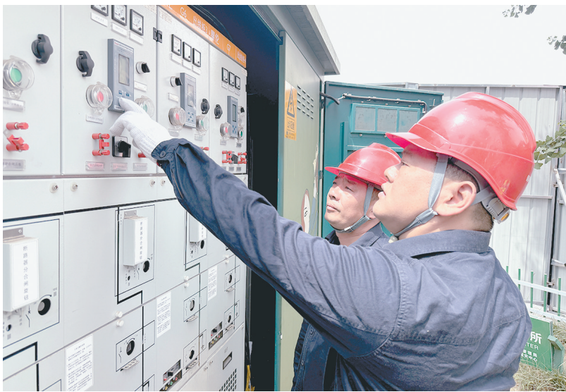
5月15日，国网漯河供电公司运维人员对会展中心供电设备进行维护，全力保障食博会顺利举办。 本报记者 孙震 摄
