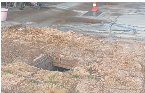
人民路与燕山路交叉口向西约200米路南，电力井盖破损。
