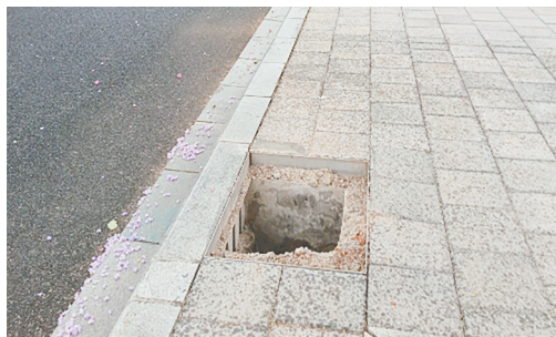
燕山路与牡丹江路交叉口向北约150米路东,人行道上井盖缺失。
