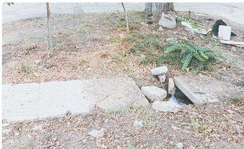
樟江东路与规划经三路交叉口向东约200米路北,污水盖板破损。
