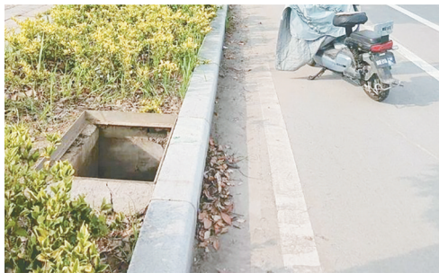
沙湾路与龙江西路交叉口向南约80米路西,污水井盖缺失。
