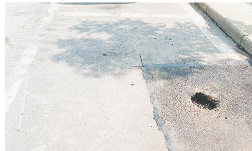
银鸽路与人民东路交叉口向北约120米路东,辅道上路面轻微塌陷。
