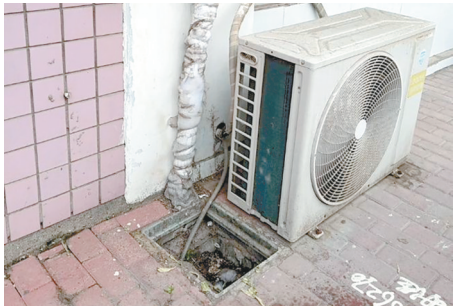
人东一巷与双汇路交叉口向北约170米路西，门面房前不明井盖缺失。
