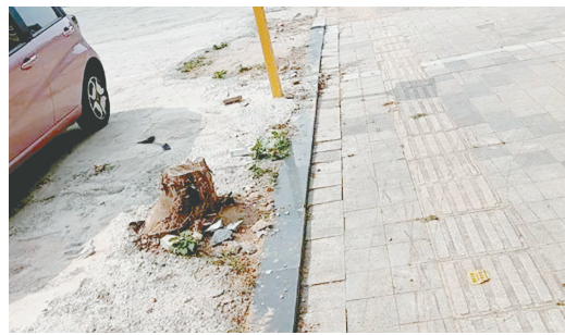
太白山中路与嘉陵江路交叉口向南约20米路西，人行道西侧有木头残留。
