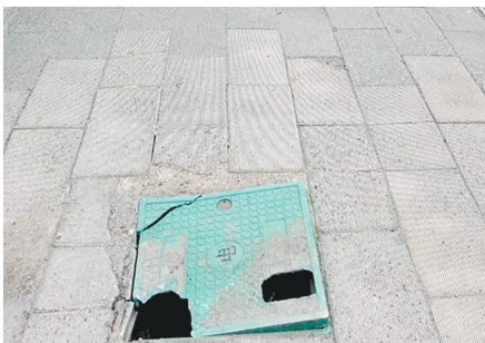
梅花山路与桂江路交叉口向南约10米路东，电力井盖破损。
