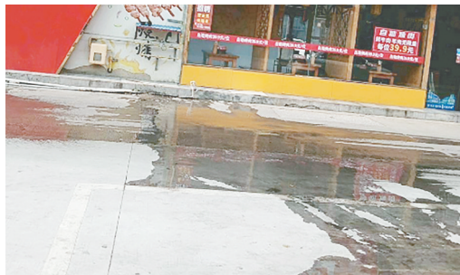
岷江路与太行山路交叉口向西约180米路南,排水管道堵塞,污水横流。
