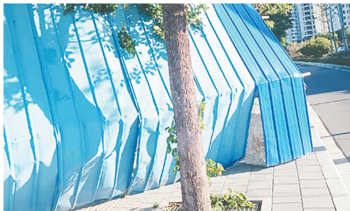
燕山路与洋河路交叉口向北约260米路东,围挡破损。
