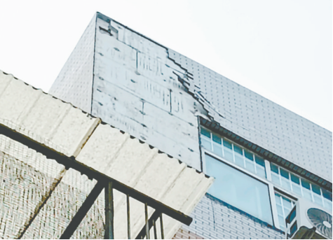
市场东路与泰山北路交叉口向西约40米路南，临街楼外立面瓷砖脱落。
