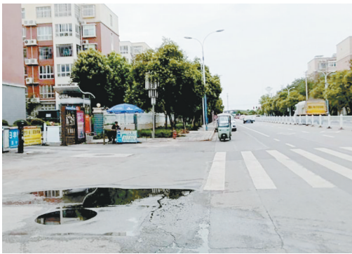
祁山路与嫩江路交叉口向南约130米路西，阳光世纪北苑东门污水外溢。
