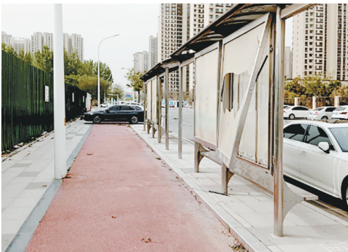
宝塔山路与泾河路交叉口向北约60米路东，公交站亭玻璃破损。
