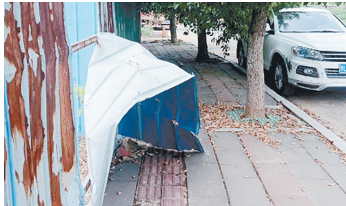
沙湾路与玉河路交叉口向北约150米路西,围挡破损。
