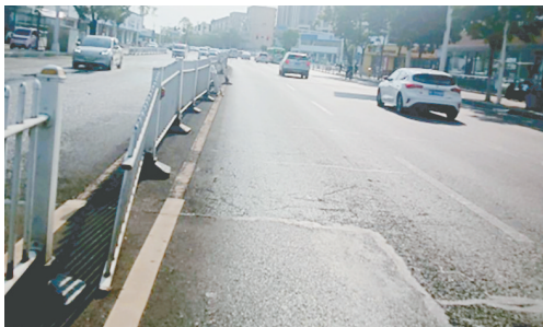
人民西路与五一路交叉口向东约70米,交通护栏损坏。
