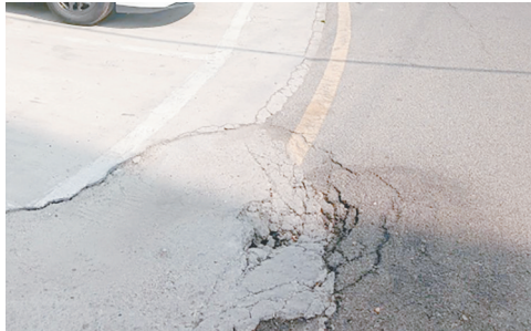
东大街与滨河中路交叉口向南约15米路西,路面塌陷。
