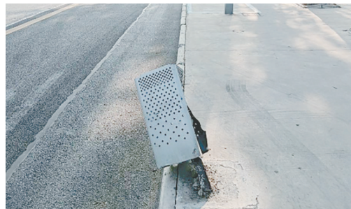
人民东路与燕山南路交叉口向东约100米路北,露天暖气排气管倾斜、防护罩损坏。
