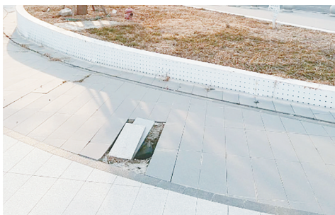
月湾湖西路与太白山中路交叉点向西约200米路南，污水井盖缺失。
