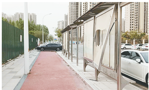
宝塔山路与泾河路交叉点向北约60米路东，公交站亭玻璃破损。
