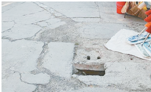
峨眉山路与桂江路交叉口向南约130米路东，井盖周边破损。
