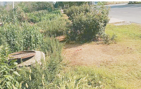
千山路与龙江西路交叉口向南约180米路东，井盖移位。
