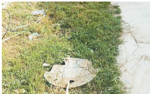
玉河路与玉泉山路交叉口向西约20米路南，井盖破损。
