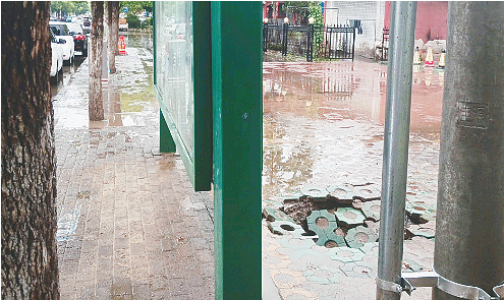
滨河东路与光明路交叉口向东约100米路北，路面塌陷。
