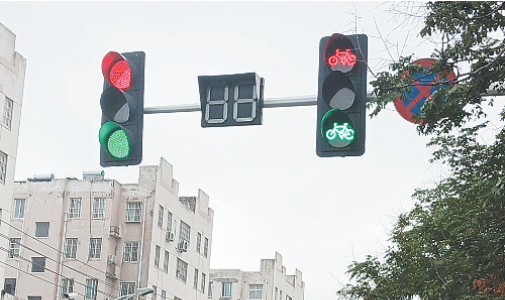
舟山路与辽河路交叉口，交通信号灯异常。
