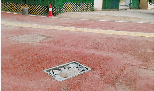
金江路与嵩山南路交叉口向西约5米路北，井盖破损。
