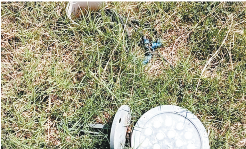
嘉陵江路与九龙山路交叉口向东约120米路北，游园内地灯损坏。
