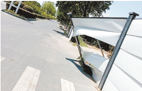
翠华山路与嘉陵江路交叉口向南路西，围挡破损倾斜。
