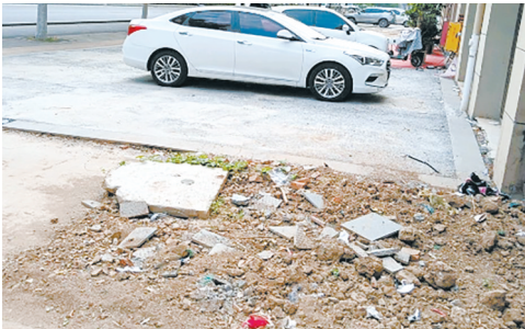
嘉陵江路与古城路交叉口向东约60米路南，人行道上渣土未清理。
