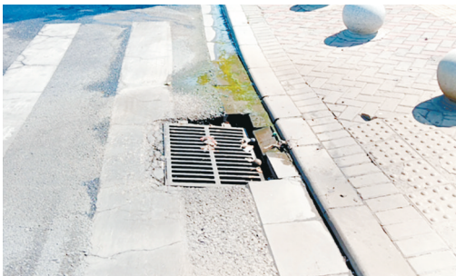
龙江路与燕山路交叉口东北角，辅道上雨水篦子一侧沉陷。
