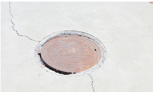
燕山路与洋河路交叉口向北约200米路西，人行道上窞井盖沉陷、松动。
