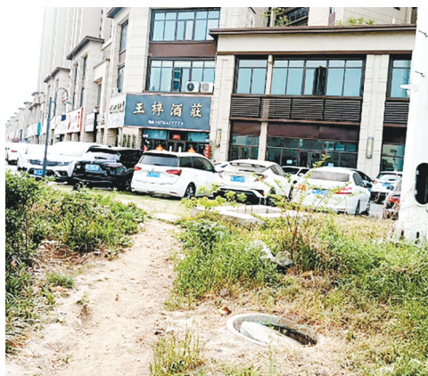
银江路与文化路交叉口向东约10米路南,绿地内通信井盖沉降,存在安全隐患。
