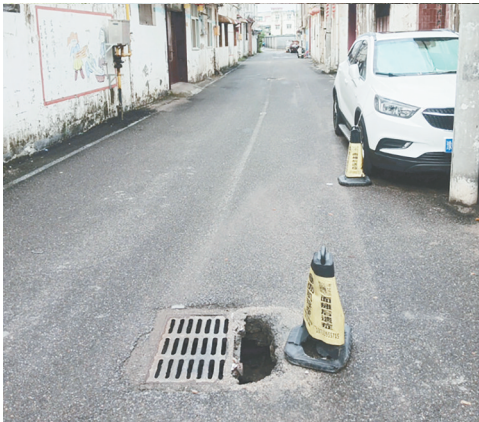
银鸽二巷与泰丰西巷交叉口向东70米路中间，雨水篦子周边破损。
