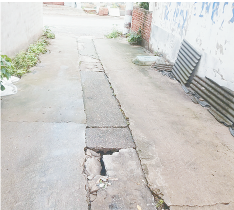
文化路与柳江路交叉口附近，污水盖板破损。
