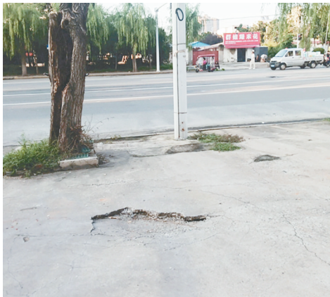
金江路与文化路交叉口向西约20米路南，路面塌陷。
