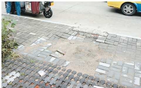
黄山支一路与泰山北路交叉口西南角，路面轻微塌陷。
