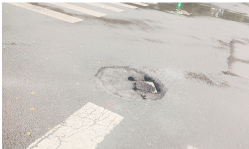
桂江路与鹤云山路交叉口，路上污水井盖破损。
