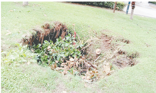
沙河南堤与五一路交叉口向西约5米路北，绿地内有坑洞。
