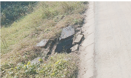
锦屏山路与柳江路交叉口向南约100米路东，污水井盖缺失。
