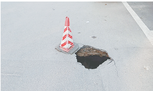
龙塔路与太行山北路交叉口向东约80米，路面塌陷。
