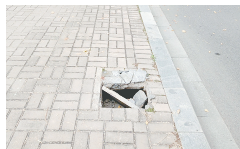
嘉陵江路与王屋山路交叉口向西约10米路南，人行道井盖破损。
