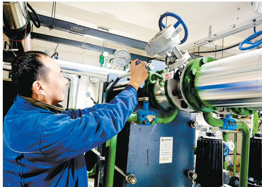
华电热力公司工作人员在检查换热站设备运行情况。
