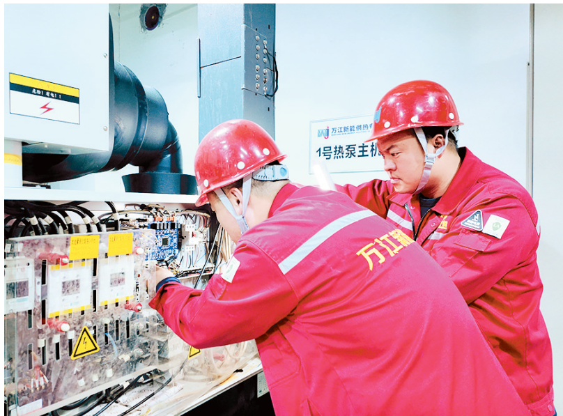
万江新能源供热公司工作人员正在对热泵主机进行检查。
