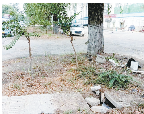
樟江东路与规划经三路交叉口向东约200米路北，污水盖板破损。
