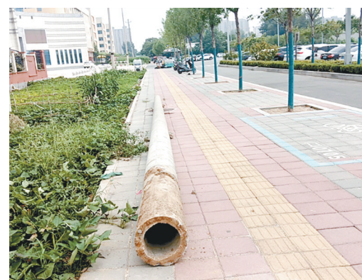
许慎路与日月潭路交叉口向南约100米路东，人行道上有废弃电线杆，影响通行。
