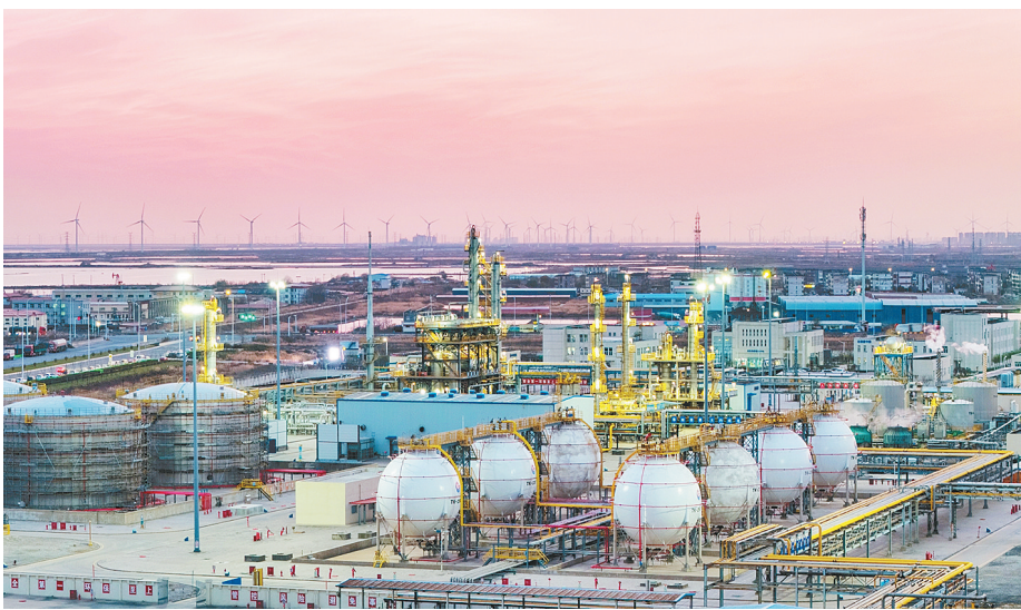
图为天津市滨海新区渤海油田渤西油气处理厂。截至12月1日，渤海油田渤西油气处理厂今年累计向天津市供应天然气超4亿立方米，为当地提供清洁能源保障。新华社发
