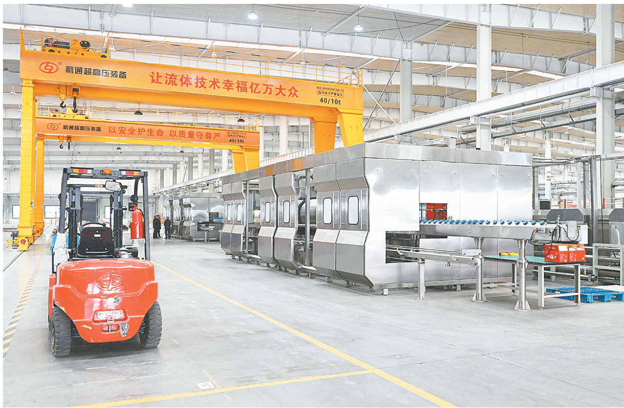
利通超高压HPP超高压灭菌车间
